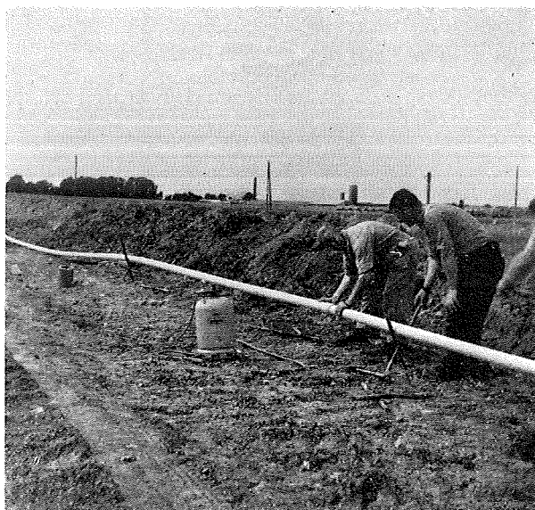
Fig. 5. Hovedvandforsyningstædning af hård Polyvinylchlorid. (Odense vandforsyning).
